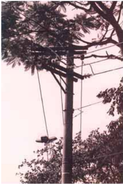
Os fios passam por dentro das copas das árvores, provocando curto-circuitos, principalmente na época das chuvas
