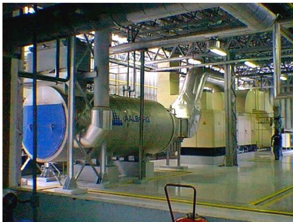
Fig. VII.2 - TURBINA A GÁS - CALDEIRA DE RECUPERAÇÃO E CHILLER DE ABSORÇÃO
