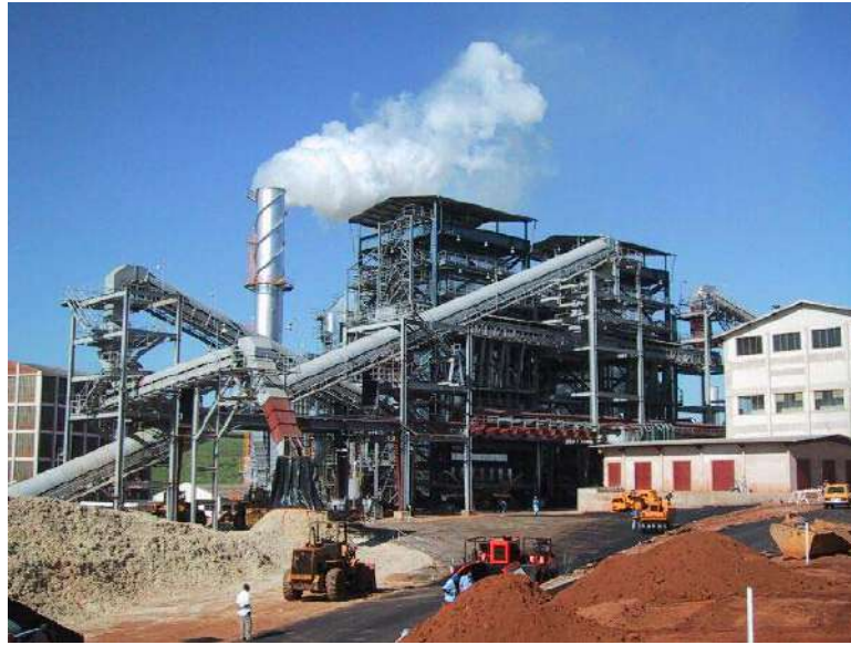
Fig. 2.12 - Vista de um Conjunto de duas Caldeiras DEDINI em Usina de Açúcar e Álcool de 175 t/h de Vapor a 62 bar e 500 °C cada uma.
