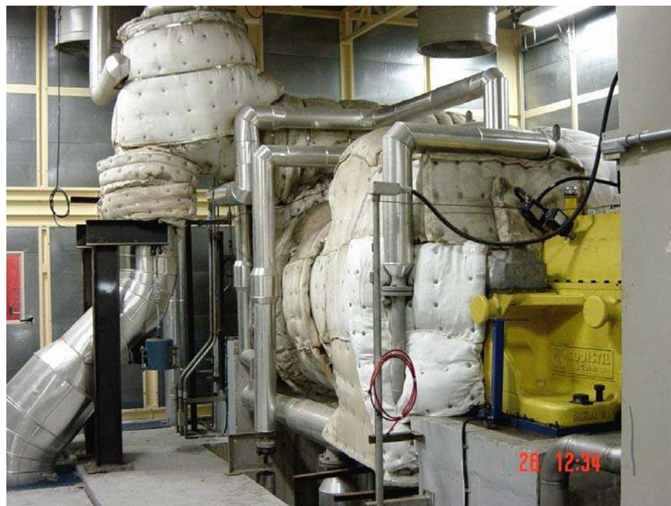
Fig. VIII.2 - VISTA DO TURBOGERADOR A VAPOR TG-03 Fonte: CSPE
