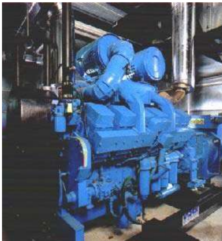
Fig. 2.25 - Instalação de Cogeração com Motor DEUTZ a Gás.
