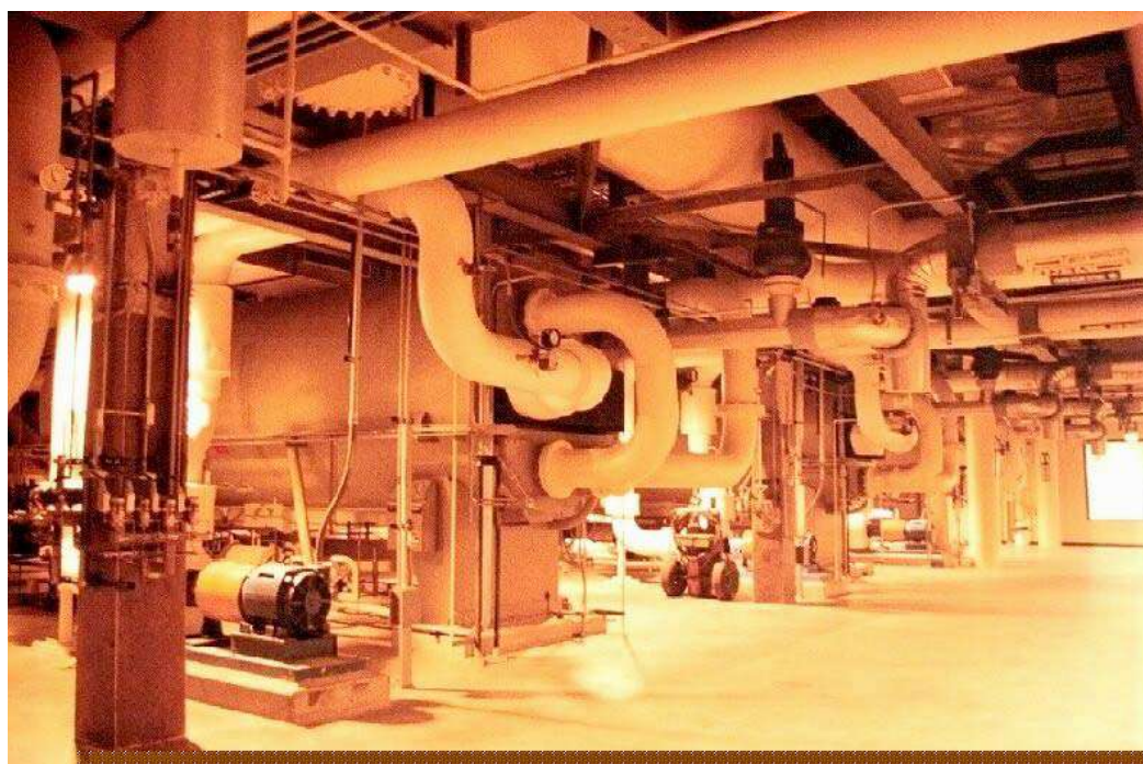
Fig. IV.2 - VISTA DOS CHILLERS DE ABSORÇÃO
