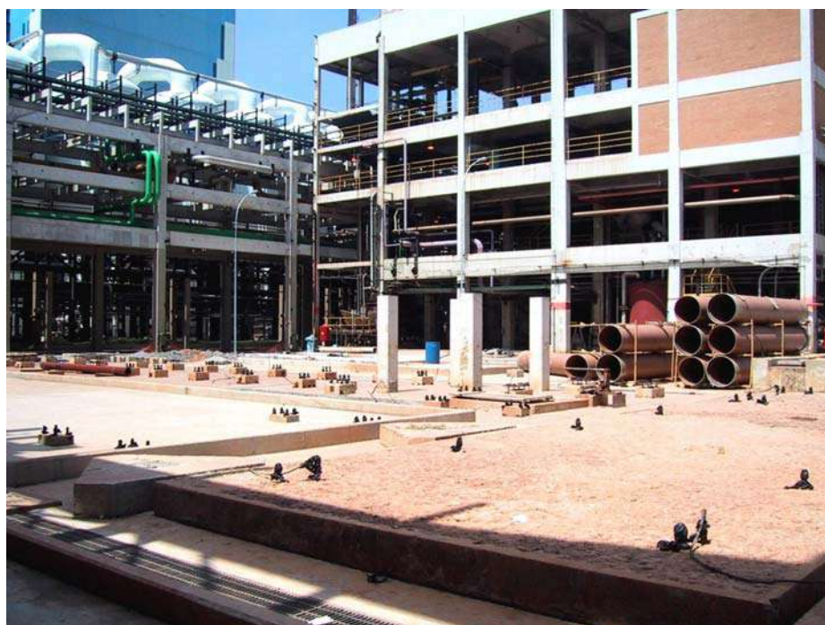
Fig. VIII.3 - SITE DE IMPLANTAÇÃO DO TURBO-GERADOR A GÁS TG-04 Fonte: CSPE
