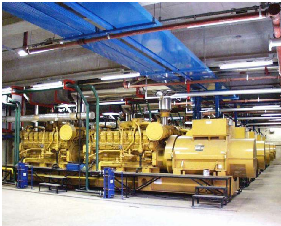
Fig. V.1 - PARQUE DE GERAÇÃO COM 5 MOTORES A GÁS Fonte: COGERAR - In: Seminário INEE de Cogeração e Geração Distribuída - 2003
