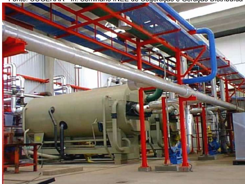
Fig. V.2 - CHILLERS DE ABSORÇÃO Fonte: COGERAR - In: Seminário INEE de Cogeração e Geração Distribuída - 2003
