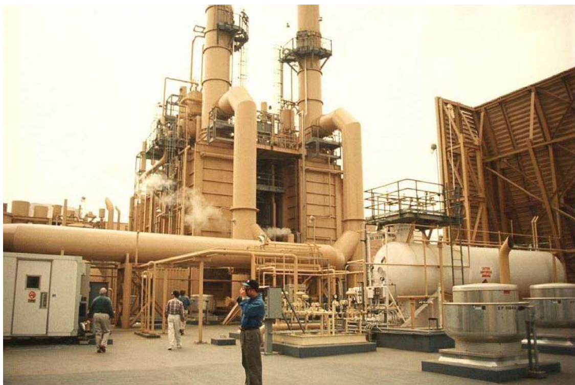
Fig. IV.1 - VISTA DAS CALDEIRAS DE RECUPERAÇÃO
