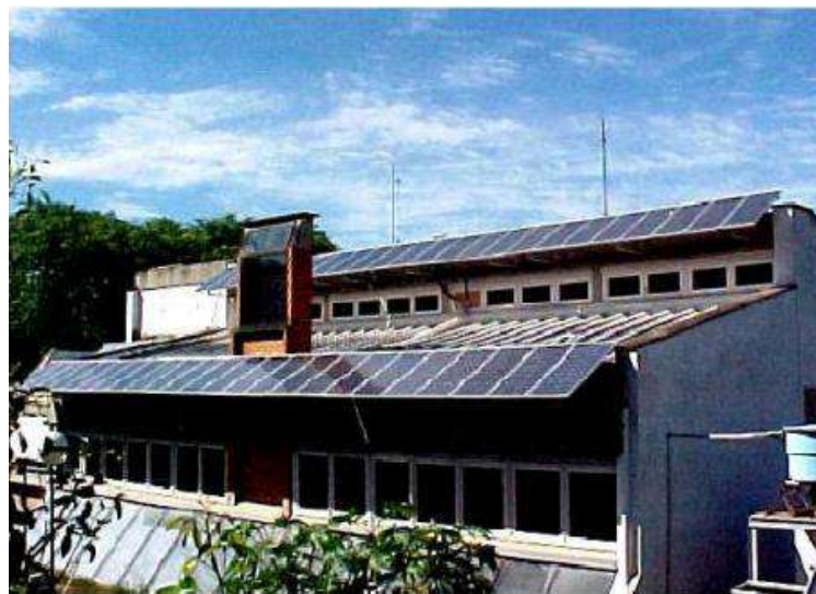
Figura 21 – Células fotovoltaicas instaladas no campus da Universidade Federal do Rio Grande do Sul
