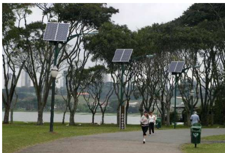
Figura 23 – Células fotovoltaicas instaladas para iluminação pública em Curitiba
