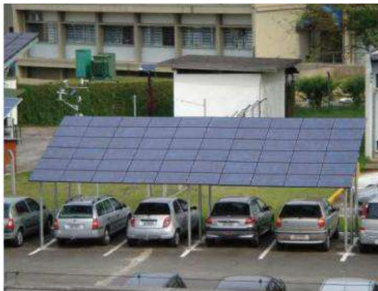
Figura 22 – Células fotovoltaicas instaladas no estacionamento do IEE-USP
