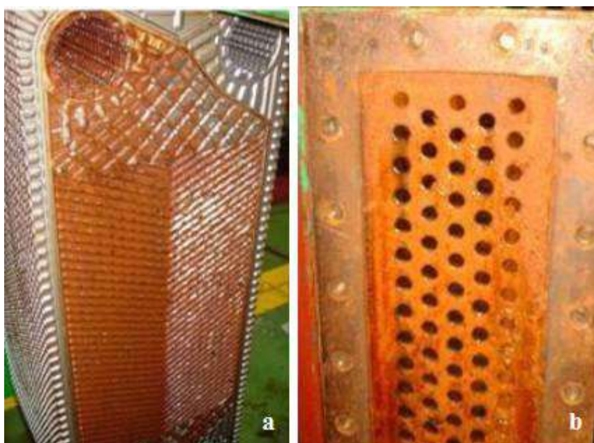
Figura 9 - Visão geral da situação em que se encontra uma das placas do trocador de calor (a), visão geral de uma das laterais abertas do radiador, em que se pode observar acúmulo de lama nos tubos de troca térmica (b)
