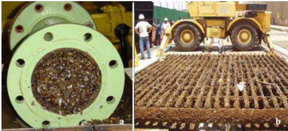
Figura 12 - Tubulação de água (a), grade da tomada d'água (b) em manutenção para retirada do mexilhão dourado.
