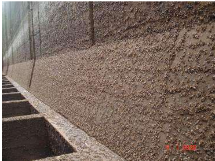
Figura 11 - Mexilhão Dourado fixado em toda a parede da Eclusa da Usina Hidroelétrica de Ibitinga
