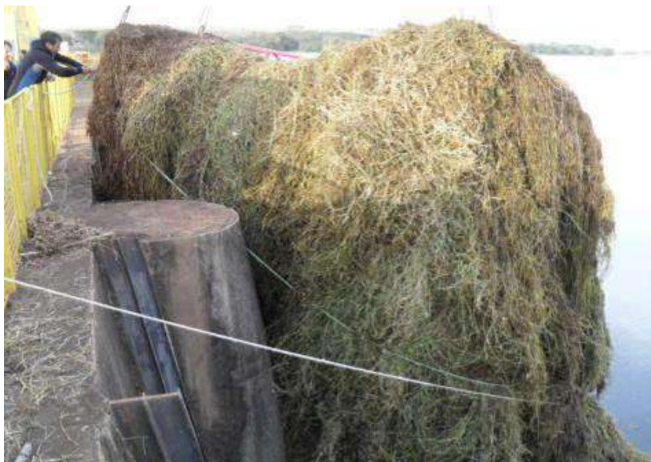
Figura 19 - Retirada de vegetação das grades de tomada d'água da UG01
