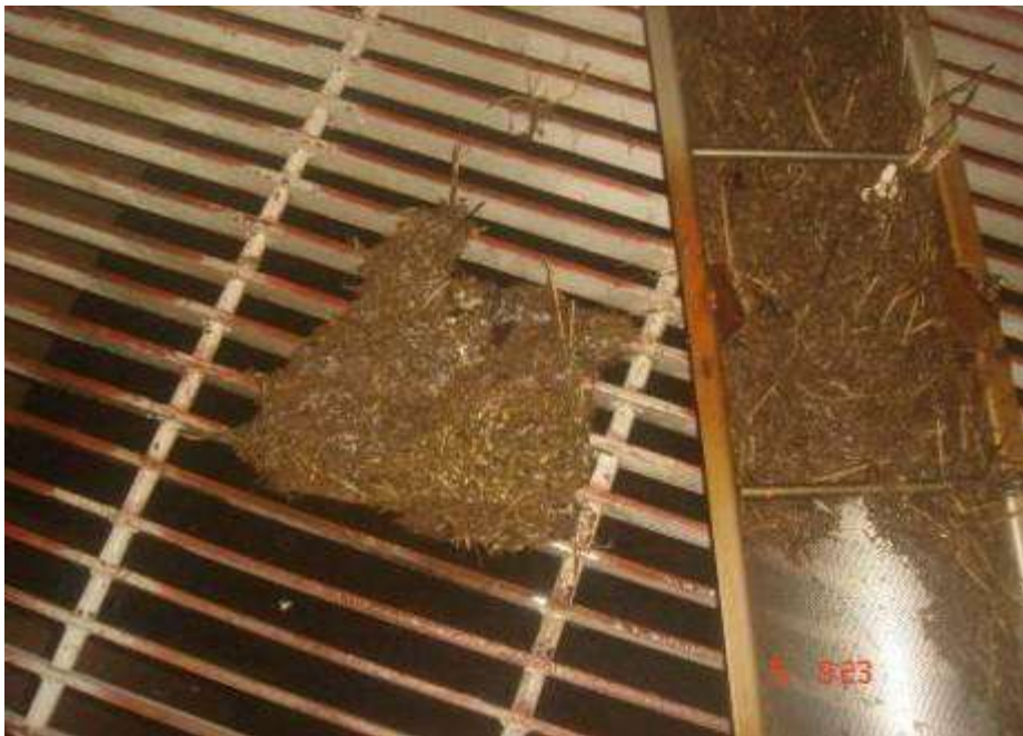
Figura 16 - Limpeza dos filtros do sistema de resfriamento principal da UG01
