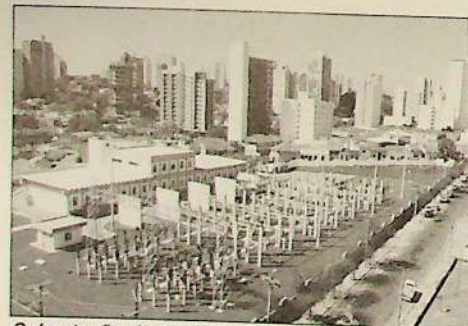
Subestação da CPFL: Campinas Central
