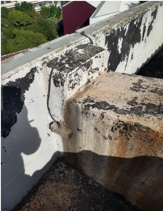
Fig. 7 – Encontro do portico com platibanda na calha
