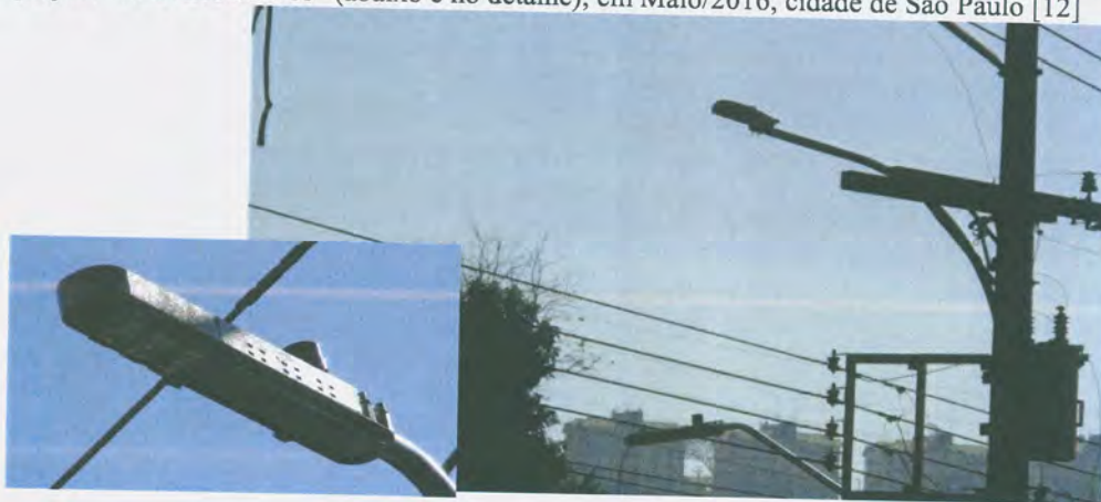
Figura n.º 16. Luminária para LVSAP (acima) e um tipo de luminária instalada durante o projeto “LED nos bairros” (abaixo e no detalhe), em Maio/2016, cidade de São Paulo [12]
