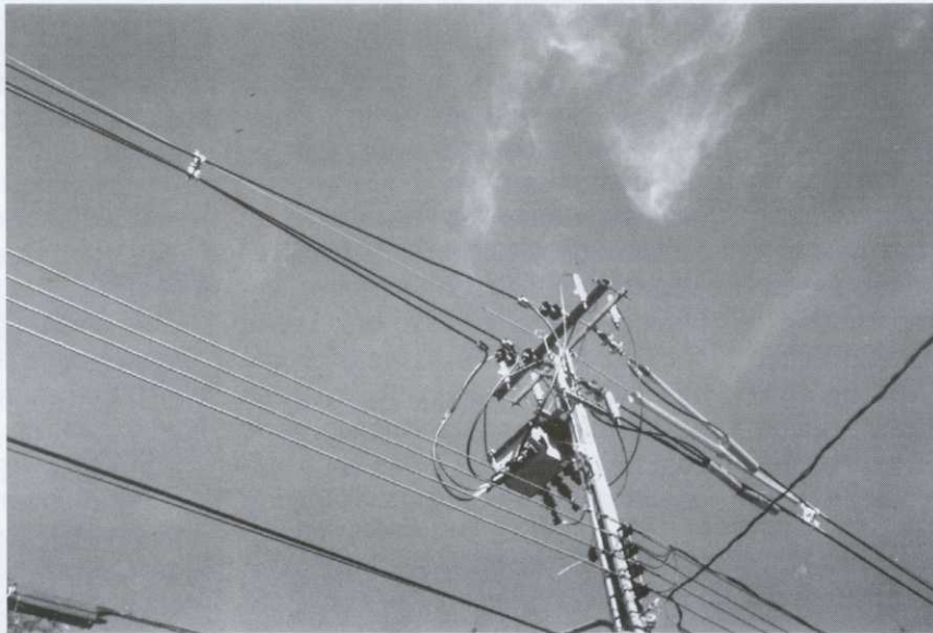
Detalhe de rede compacta com cabo coberto
